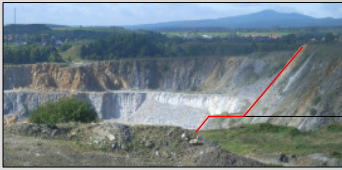
Nordböschung (rote Kontur), Gefahr des Abgleitens auf verdeckter Gleitfläche
